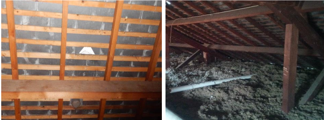
Figure 12 : Illustration du comble (à droite) et d'une ventilation de toiture fermée par du grillage (à gauche)
